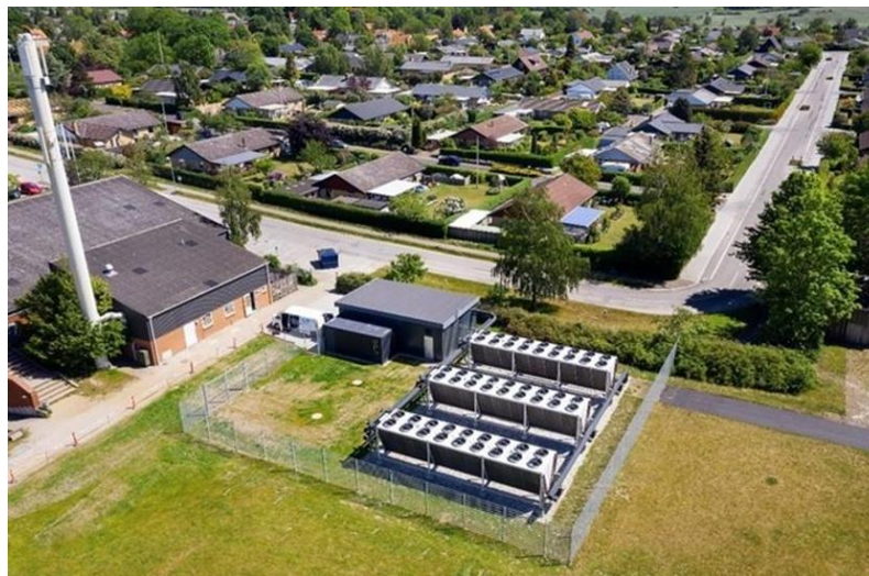
Abbildung 32: 1,2 MW Luft-Wärmepumpe in Slagslund Dänemark (Quelle: PlanEnergi)
